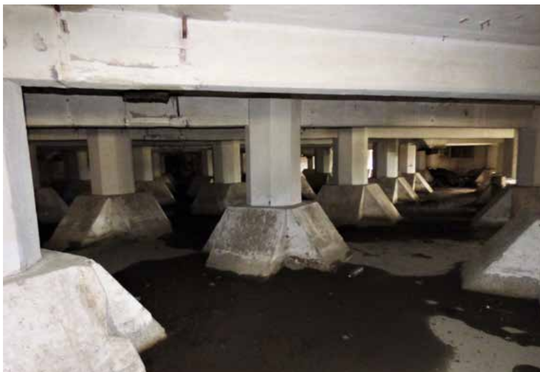
30. Fotografia del piano interrato (-1.60 metri) In evidenza i plinti di fondazione su pali
